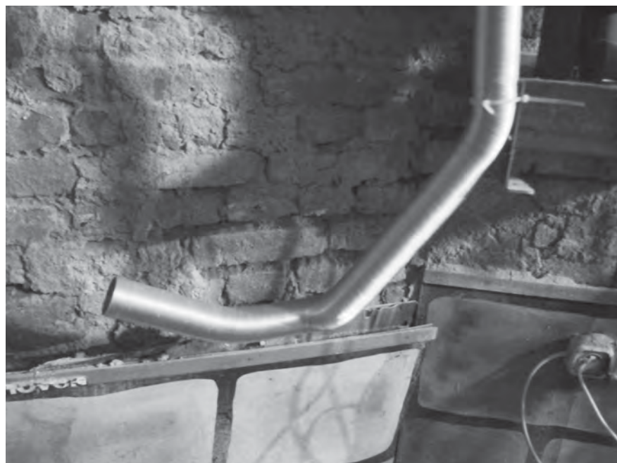
Abb. 4: Abluft-Rohr (nach innen) einer Absauganlage
